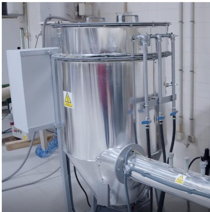
Figura 3. Detalle del sistema de filtración piloto - Reactor multimanga.
